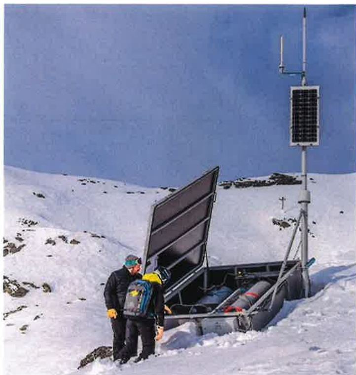
Photographie d'un abri Gazex type coffre
